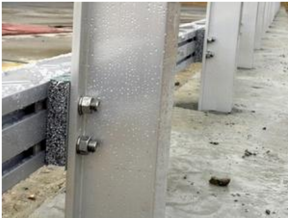
شکل (۱۸): استفاده از فوم در گاردریل ها برای جذب ضربه وارده
